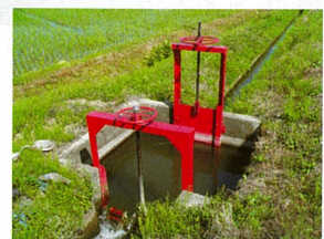
『農地・水・環境保全』事業等により適正に管理された施設
