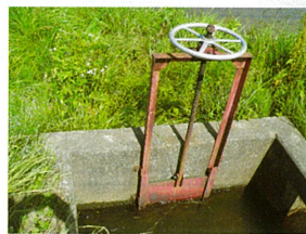
適正な管理を行っていない施設
