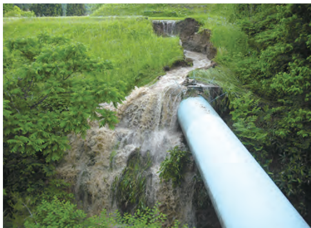
大地震の影響による漏水発生
