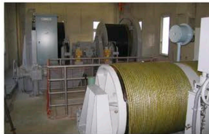
取水塔内部(ゲート巻上機)
